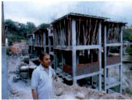
हमीरपुर, हिमाचल प्रदेश में, निर्माणाधीन आई.एच.एस.डी.पी. परियोजना के ब्लॉक संख्या 1 से 6 (18 मई 2011)
