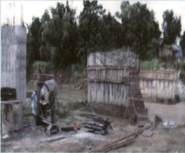
अपूर्ण पुल का फोटोग्राफ "पुराना बाजार (रा.रा.39 बाइपास) से कोहिमा-कोकाजन तक सड़क" (अक्टूबर 2008)।
