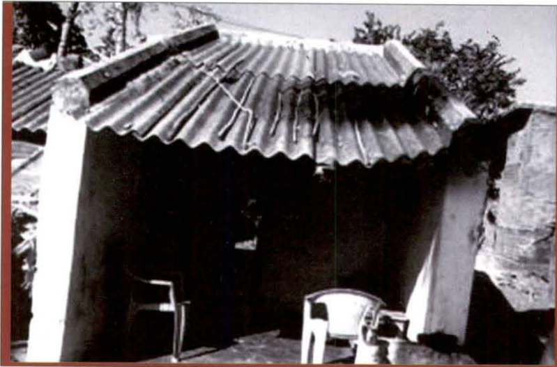
प्रदर्शन 4.6 पार्वतीपुरम परियोजना, विजयानगरम जिला, आन्ध्र प्रदेश में टूटा फूटा आं.के. भवन
