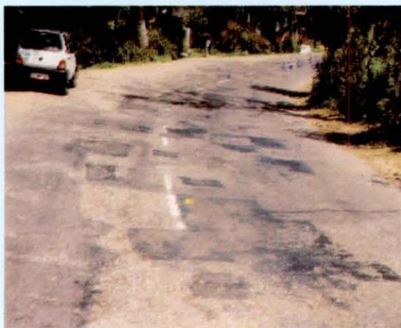
Mubarikpur-Ranital-Kangra road (km 115/200)
