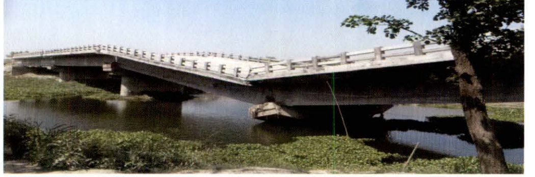
मुजफ्फरपुर में रून्नीसैदपुर-कटरा-केवत्सा पथ पर क्षतिग्रस्त पुल
