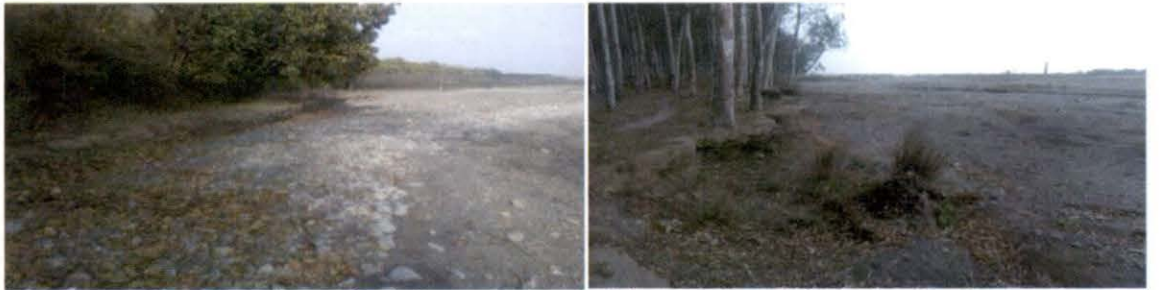
तटबंध (1.650 से 5.100 किलोमीटर) का निर्माण न करने के कारण सुंकर नदी के किनारे पर मिट्टी कटाव
