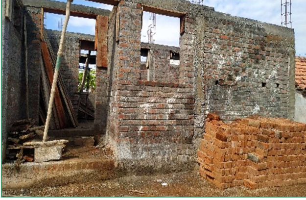
பெயர்: சூசைபெரியநாயகம் (TN1413866) அழகானேந்தல்: இன்னும் கூரை போடப்படாத வீடு, கட்டி முடிக்கப்பட்டதாகக் காட்டப்பட்டுள்ளது - 24/06/2020
