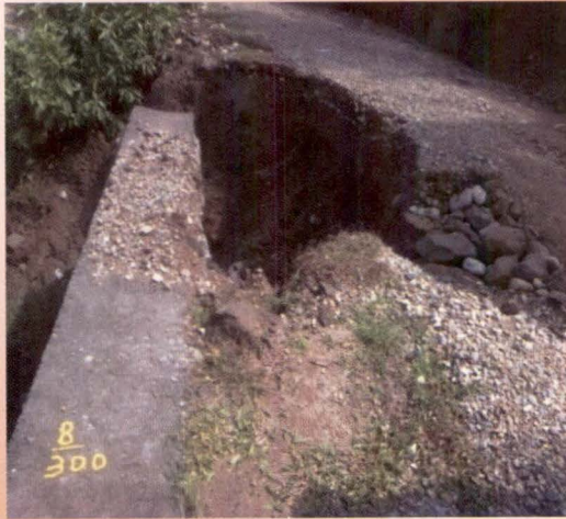
जम्मू और कश्मीर के कठुआ जिला, में गलक से अपन राजवलटा तक सड़क में पर्याप्त संख्या में आर-पार जलनिकासी की व्यवस्था का निर्माण न किया जाना
