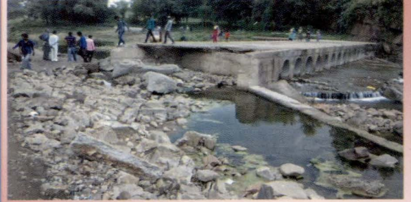
गुजरात के दाहोड जिला, में 'कामबोई पटेल फेलिया' सड़क के चनेज 1/800 पर पानी को सुरक्षित रूप से आने जाने के लिए पाइपों के निर्माण न करने के कारण पुलिया का निर्गम भाग बह गया
