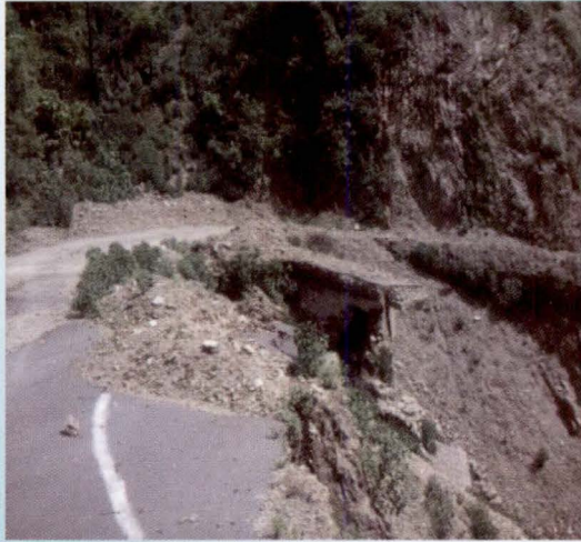
उत्तराखंड के पौड़ी जिला, में नौगांव से भूखंडी सड़क क्षतिग्रस्त पाई गई थी।
