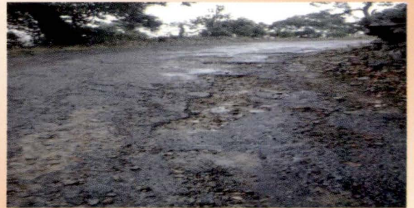
उत्तराखण्ड के पौड़ी जिला में विभिन्न स्थानों पर मेलसेन से चोपडा तक सड़क का बिटुमेनी कार्य क्षतिग्रस्त पाया गया था।
